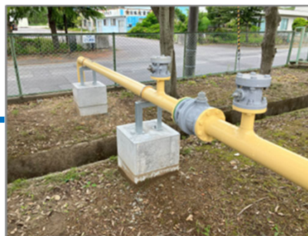
● 工場内引込部分
