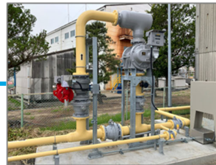
● 緊急遮断装置
